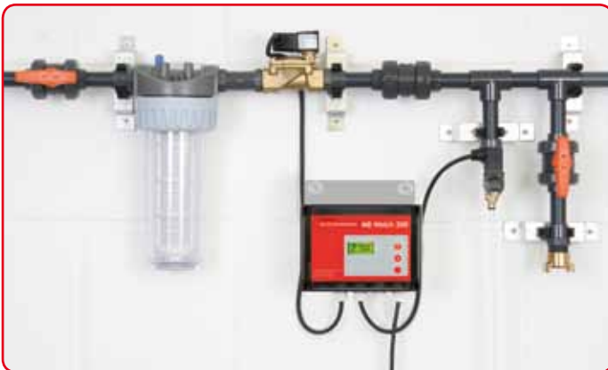
Zentrale Einheit mit Steuerung MBWeich 200 und Filter, Druckentlastung, Desinfektionsanschluss
